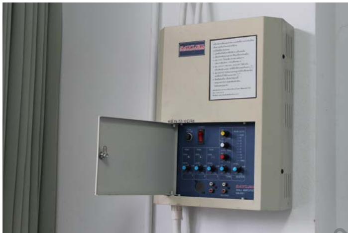
5. สภาพอุปกรณ์เครื่องขยายเสียงห้องเรียนไอทีพร้อมใช้งาน
